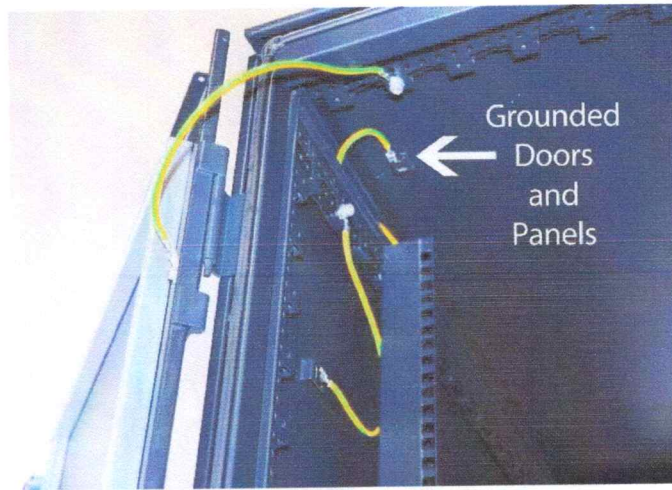
Gambar 4. Ilustrasi grounding pada network cabinet
